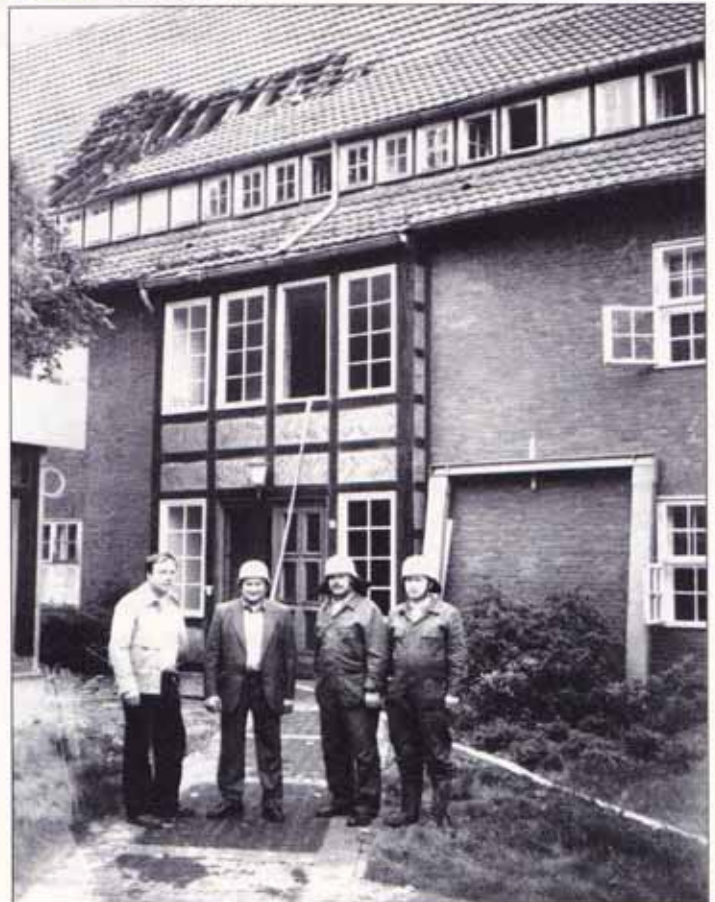
Kameraden der LKH-Löschgruppe nach dem Brand im Dachgeschoss in Haus 19. Foto: H. Schmidt
