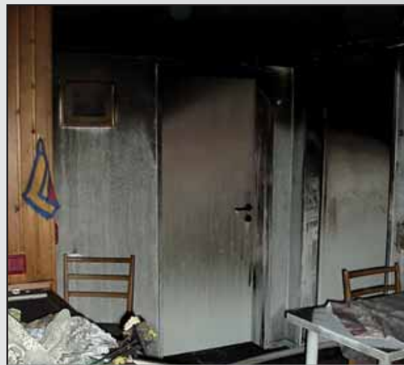
der Brandrauch hat enormen Schaden angerichtet
